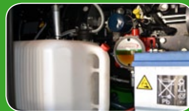
3 Réservoir d'eau distillée
