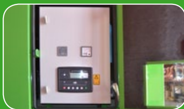
5 Tableau de contrôle
